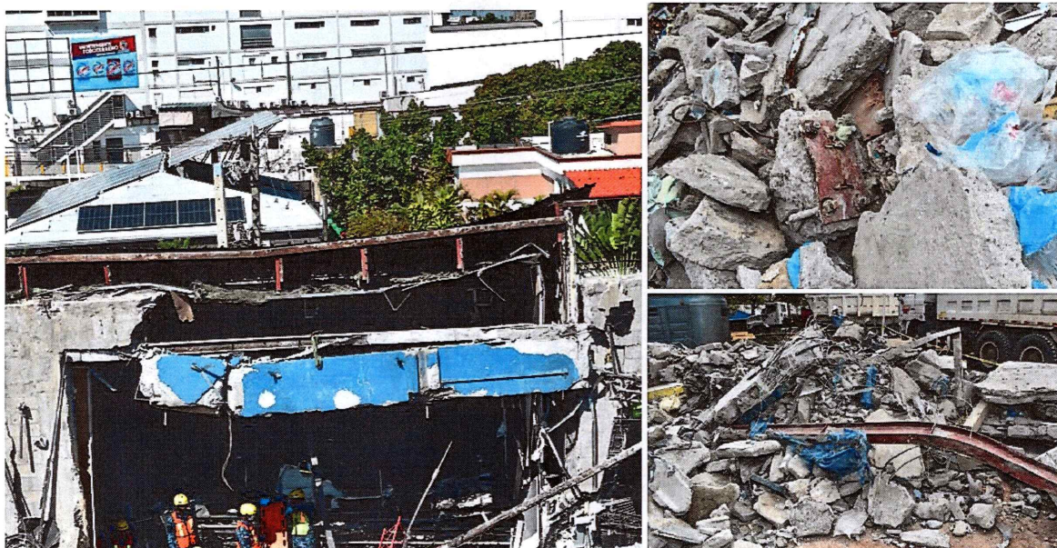
IMAGEN 20: PERFIL METÁLICO DE REFUERZO BAJO VIGA ENCIMA DEL ESCENARIO, NÓTESE LA PLACA DE ACERO REFERIDA
