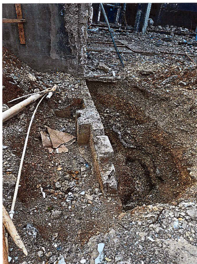
IMAGEN 28: ZAPATA DE LA COLUMNA ELIMINADA EN ESCENARIO-.
